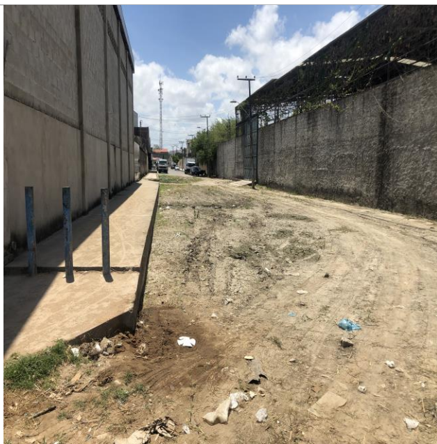
Figura 05 - Ausência de drenagem e pavimentação da Rua Cap. Gutemberg (Fonte: SEINF, Novembro/19)
