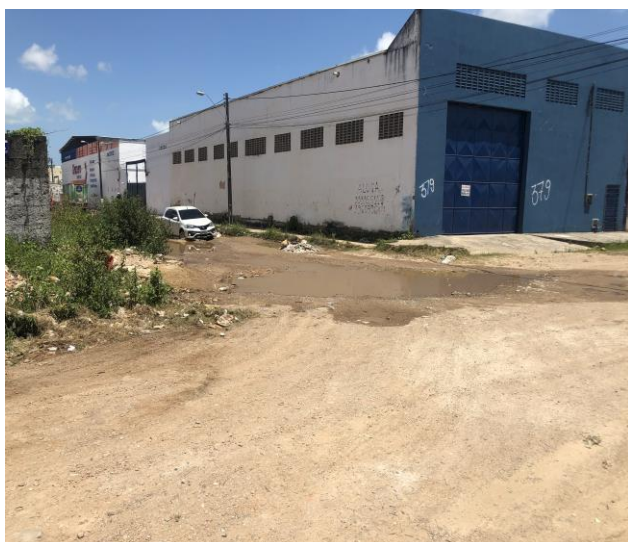
Figura 03 - Ausência de drenagem e deformações no pavimento da Av. Júlio Jorge Vieira (Fonte: SEINF, Novembro/19)
