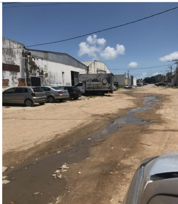
Figura 06 - Ausência de drenagem e deformações no pavimento da Av. Júlio Jorge Vieira (Fonte: SEINF, Novembro/19)
